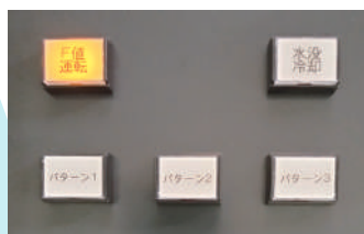
操作パネルのF値運転ボタンON
